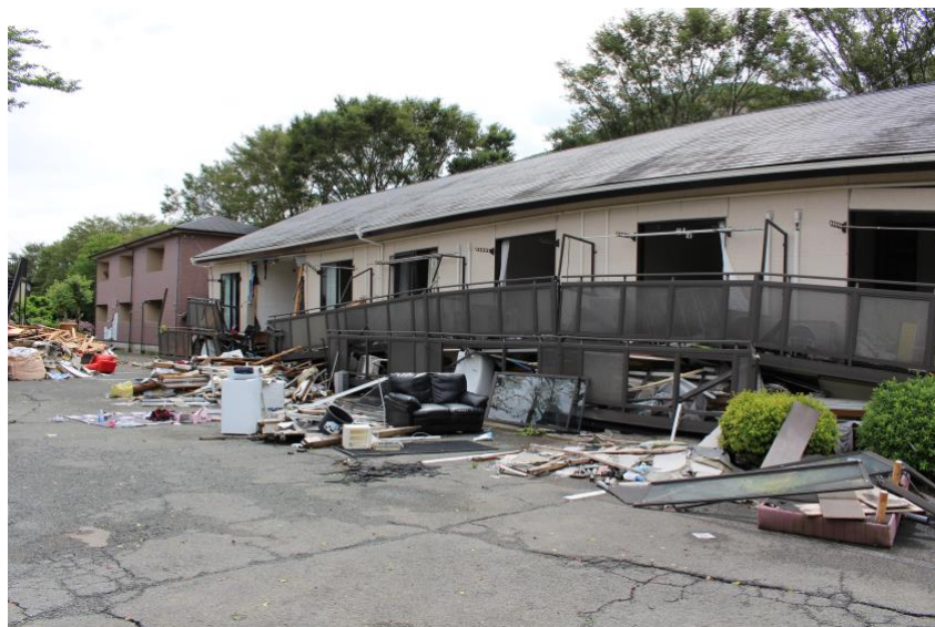
1階が押しつぶされたアパート
